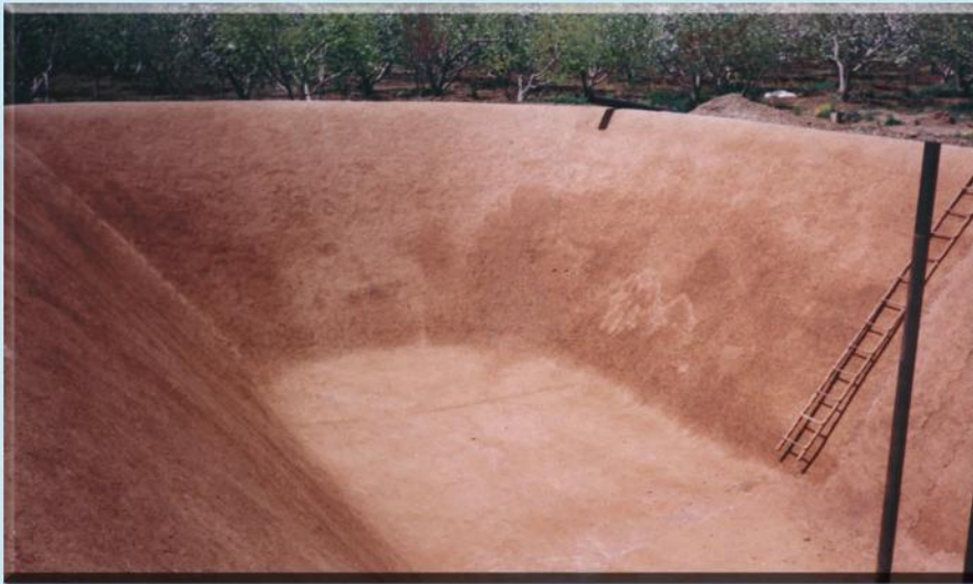
بستر آماده جهت نصب ورق پلی شیت کلیه عملیات بستر سازی بدون نیاز به هیچگونه اطلاعات فنی امکان پذیر می باشد متی شما کشاورز عزیز به رامتی قادر به ایجاد بستر مناسب برای نصب ورق می باشید .
